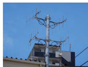
地上基地局 アンテナ
